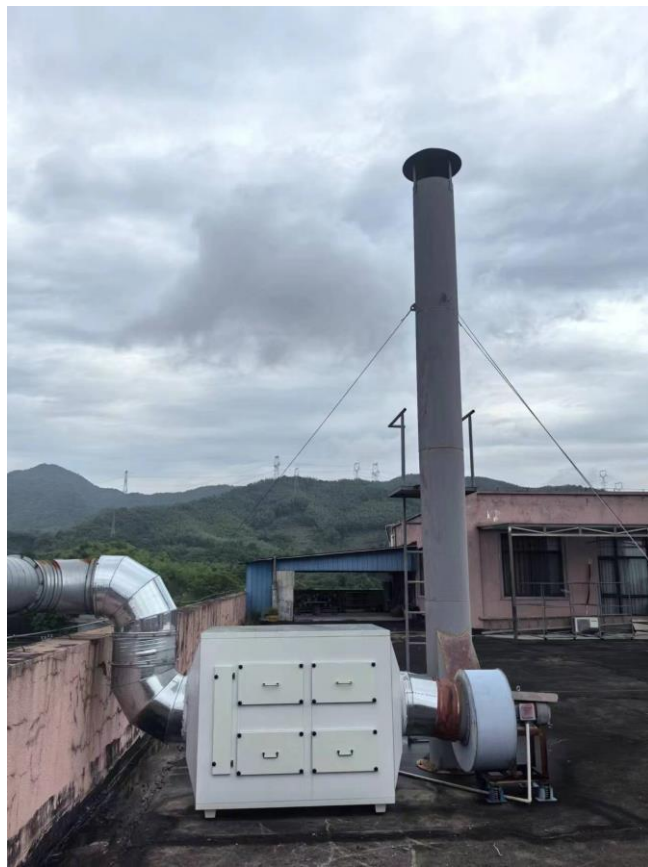
图 3.1-4 活性炭吸附装置及对应排气筒
