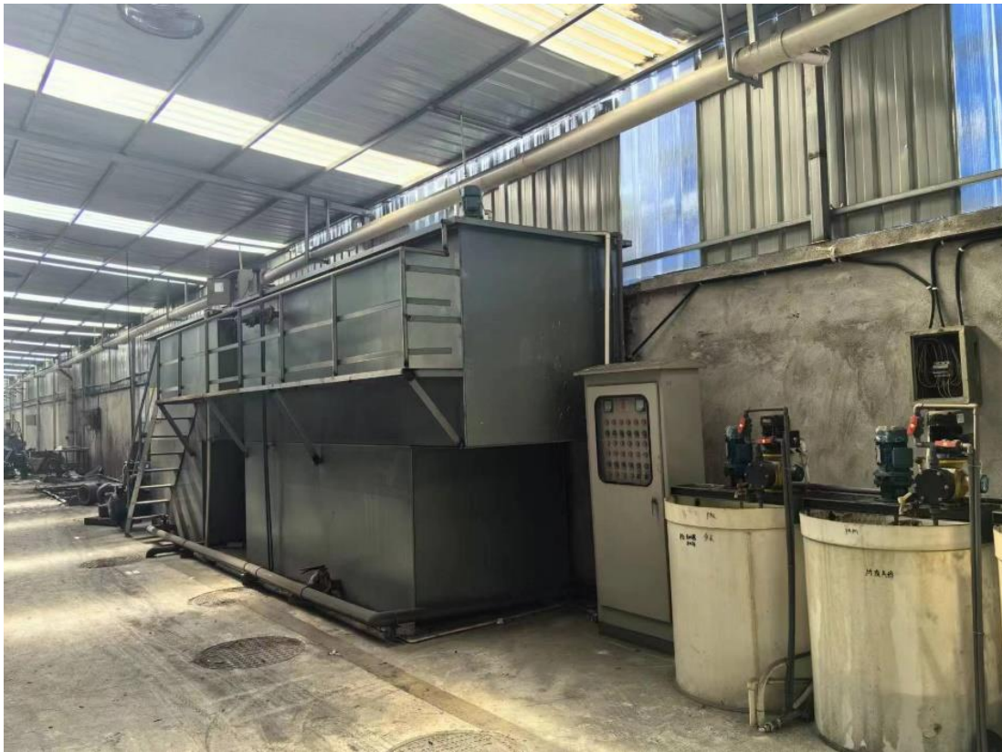
图 3.1-1 厂区废水处理站
